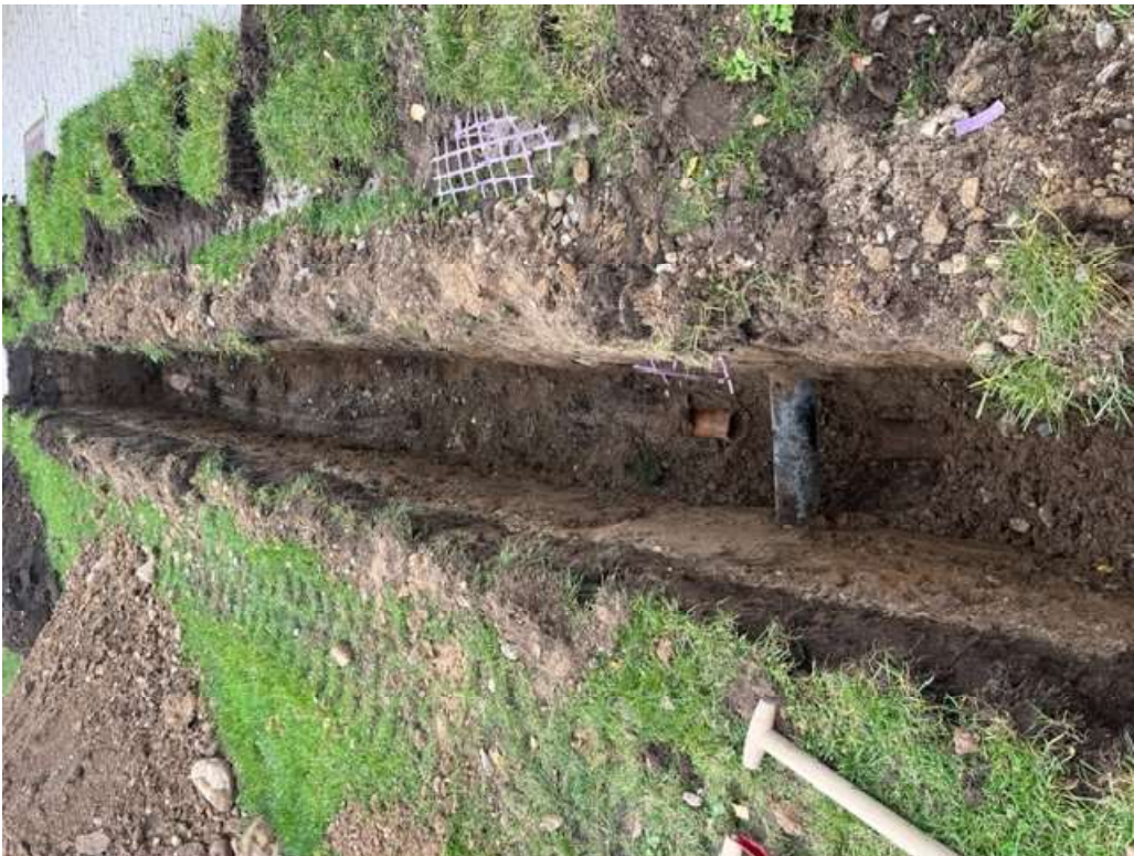
Foto 2 Drænledning ses overgravet og i øvrigt udført uden egnet filtermateriale
