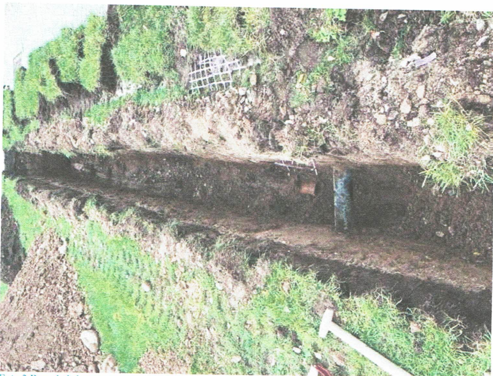
Foto 2 Drænledning ses overgravet og i øvrigt udført uden egnet filtermateriale
